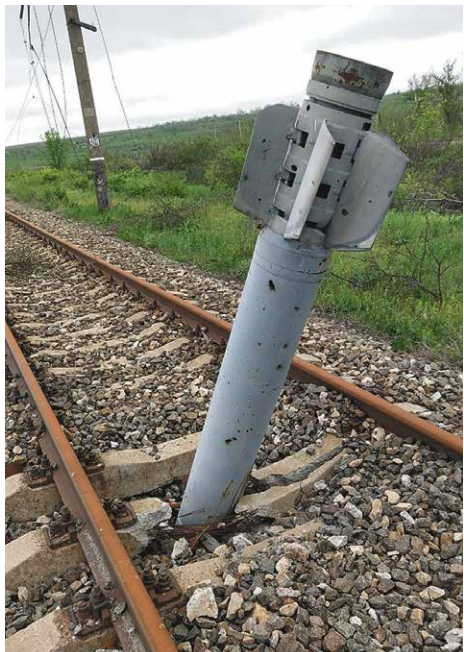
Снаряд от РСЗО, застрявший в железнодорожном полотне.
